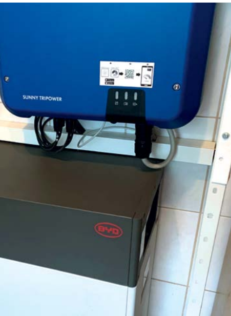
Batteriespeicher und Wechselrichter beanspruchen im Haus nicht viel Platz
